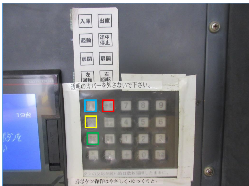
操作盤拡大写真
