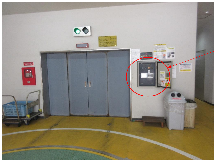
立体駐車場操作盤
