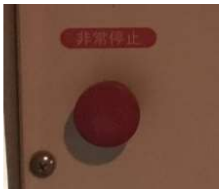
非常停止ボタン
