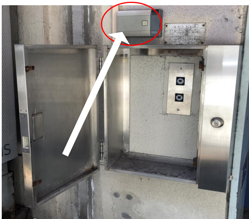
カーリフト操作盤
